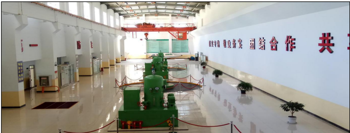
图 2-12 发电厂房内部情况
