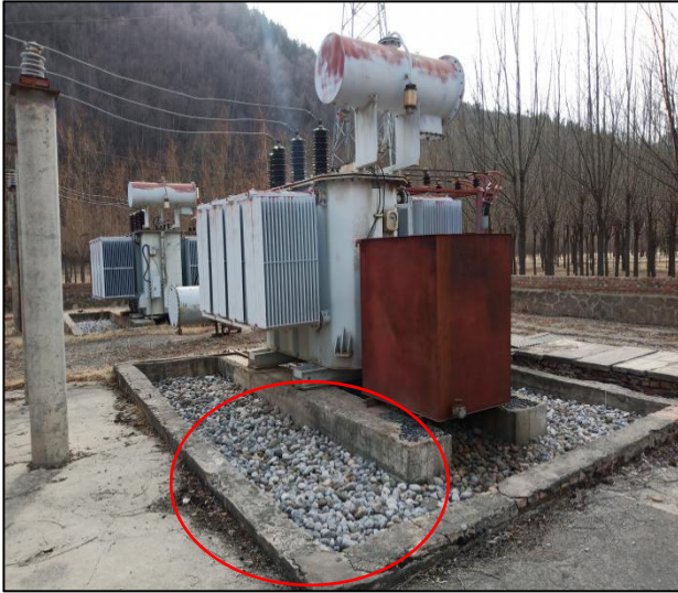
图 2-22 变压器鹅卵石池及围堰
